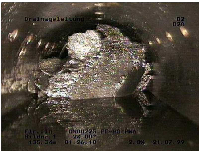
Abbildung 3 Beeinträchtigtger Sickerwasserabfluss infolge Rohreinbruch
